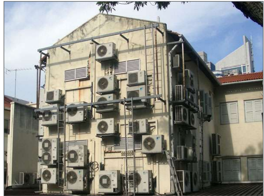
Stand-Alone-Geräte an einer Hausfassade einer IT-Firma
