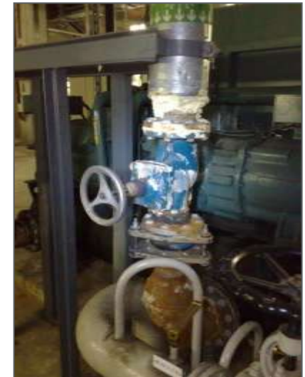
Mangelnde Instandhaltung einer Kühlwasseranlage
