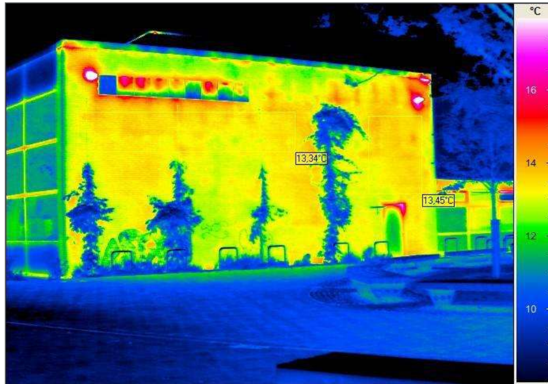
Mangelhafte Wärmeisolierung der Außenfassade einer Produktionshalle
