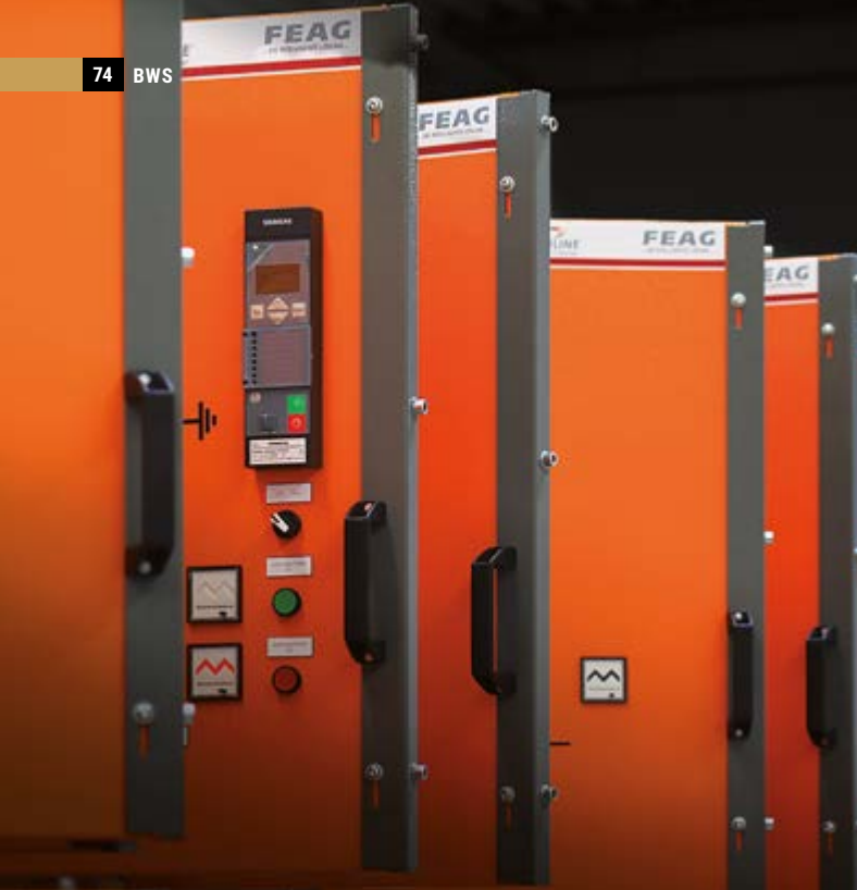
Mittelspannungsschaltanlage Energoline MV12.
